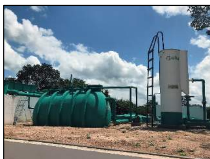
Figura 98: Estação de Tratamento de Esgoto do IIN-ELS.
