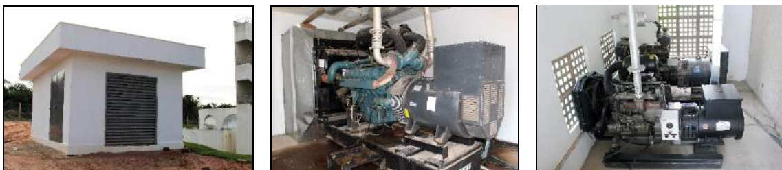
Figuras 99, 100 e 101: Geradores elétricos do IIN-ELS.
