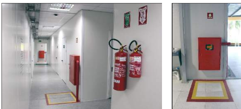
Figuras 106 e 107: Melhorias nas instalações de combate a incêndio do prédio do CEPS.
