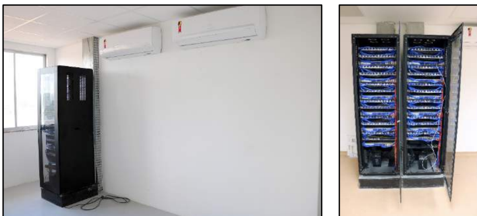
Figuras 88 e 89: Instalação de servidores do Centro de Processamento de Dados (CPD).
