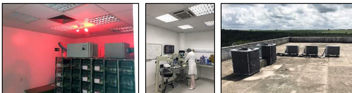
Figuras 95, 96 e 97: sistema de climatização em áreas especiais como biotério de ratos e camundongos e salas de cirurgia.
