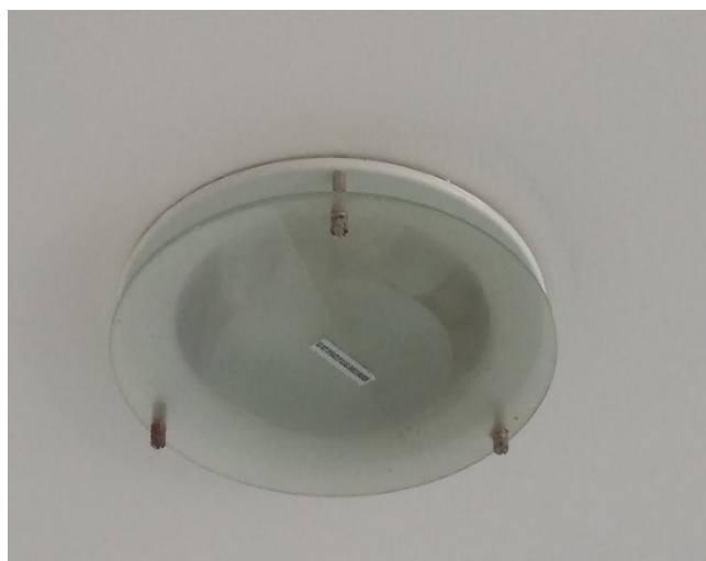
Foto ilustrativa da luminária do refeitório
