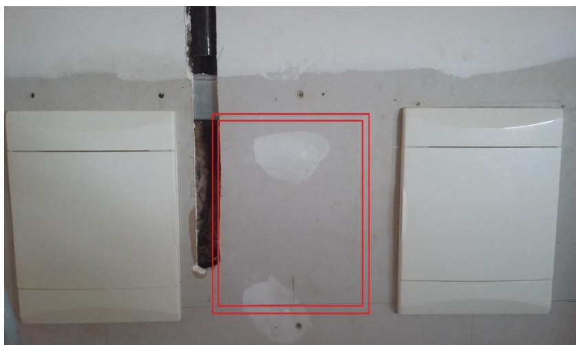
Local do quadro de distribuição
